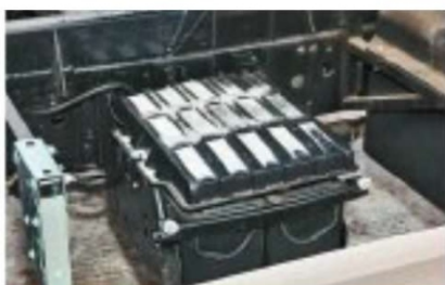
Аккумуляторные батареи накрыты общей пластиковой крышкой
